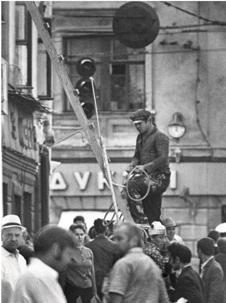
Михаил Дашевский. Ремонт на Солянке. Москва. 1960-е гг. Mikhail Dachevsky. Repairing. At Solyanka street. Moscow. 1960s
